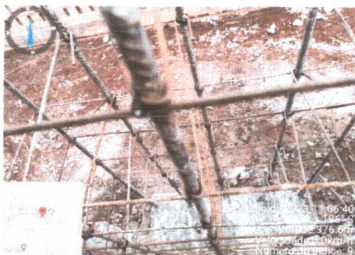
Foto 04 : pilar P39 completamente rompido
