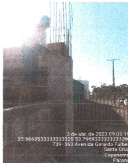
Foto 02 : rompimento pilar P39
